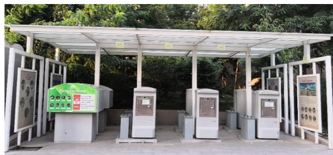
气力输送系统投放口
