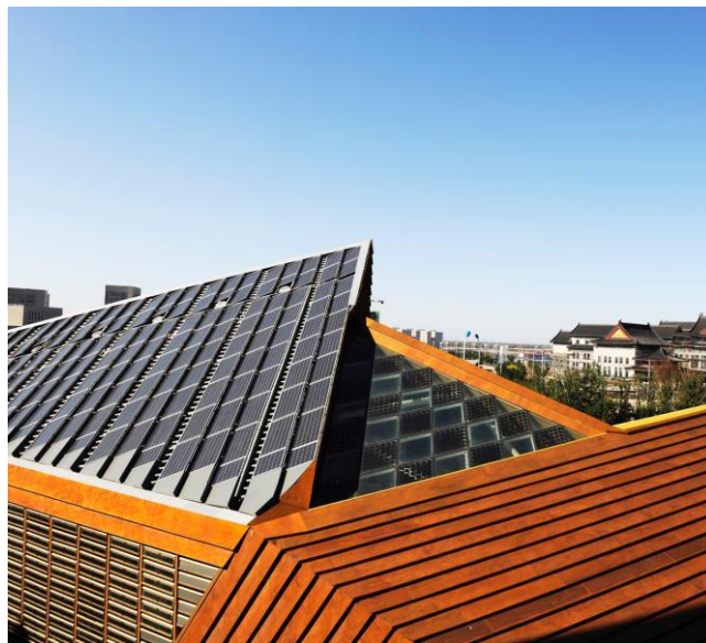
屋顶太阳能光伏发电
